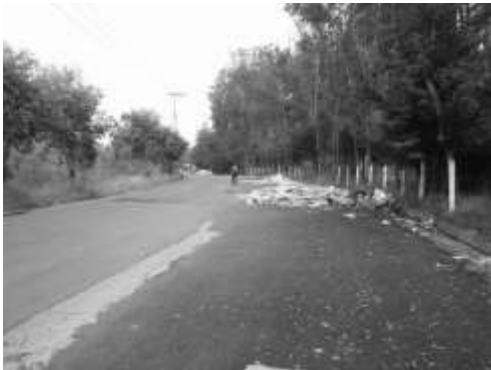
Imagen-11 Estado Actual de calzada de los Arcos.
